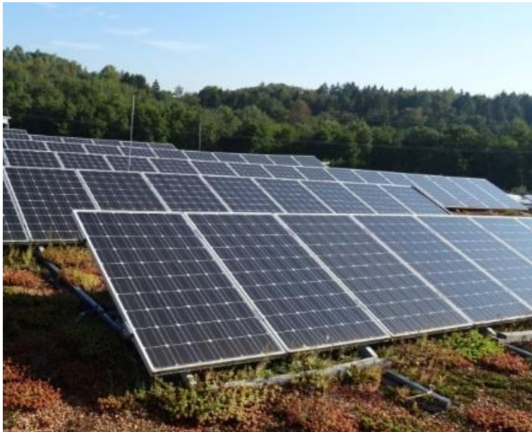
Abbildung 13: PV Anlage BODAN
