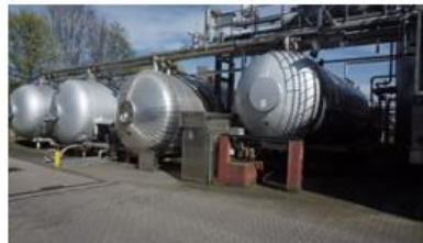
Kohlensäure tanks der fertig aufbereiteten und versandfertigen Kohlenensäure
